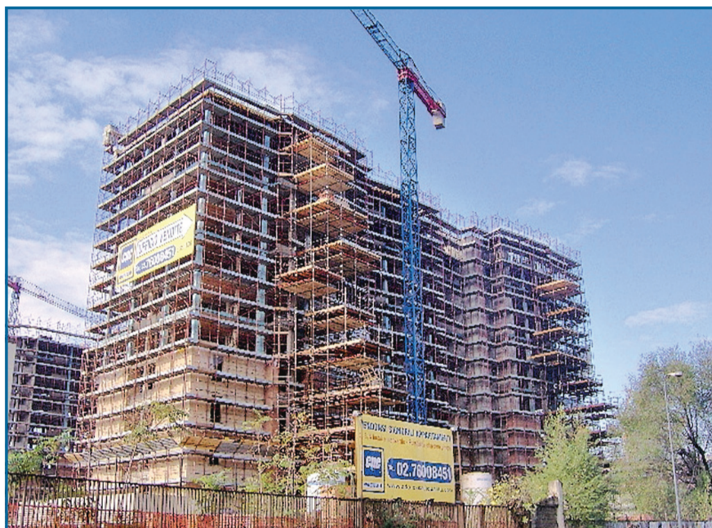
Gli edifici in costruzione nel nuovo quartiere che si affacciano su via Adriano
